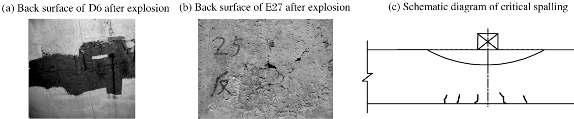
图 3 临界震塌现象
