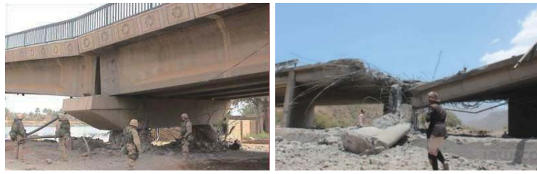
图 1 爆炸荷载作用下倒塌的桥梁 [2-3]
