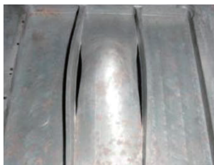
图 8 爆炸作用下加筋处的撕裂破坏 [66]
