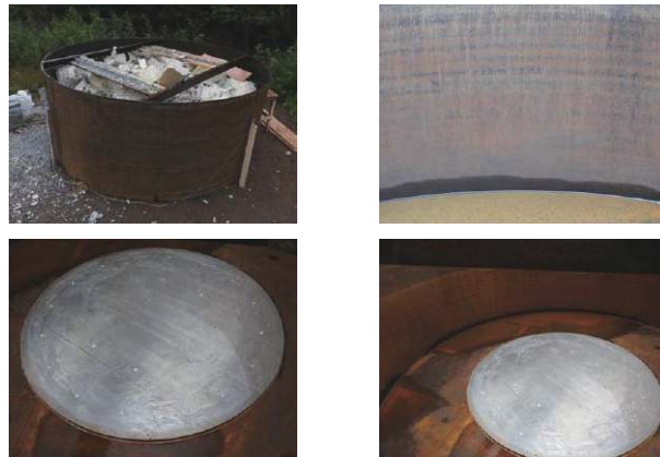
图 8 回收池侧壁和底部状态
